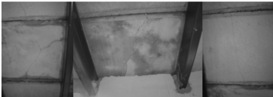
Figura 3.4. Fisuras producidas en el techo Domozed, durante la colocación de la capa de compresión superior.
