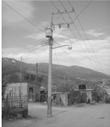
Figura 1.46. Condiciones de calles sin pavimentar, la red de energía eléctrica y alumbrado público.
